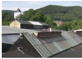
Drahtglas-Sattellichtband vor der Sanierung
